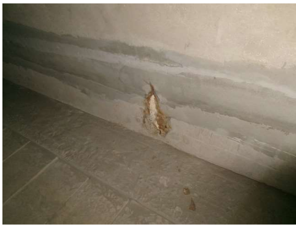
NATM구간 측벽부 S46 균열 및 누수(스며있음)
