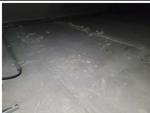
풍도슬래브 상면 S53 이음부 몰탈파손
