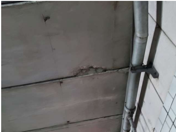
풍도슬래브 하면 S54 파손
