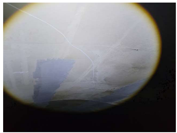
NATM구간 천단부 S51 균열(Cw=0.5mm)
