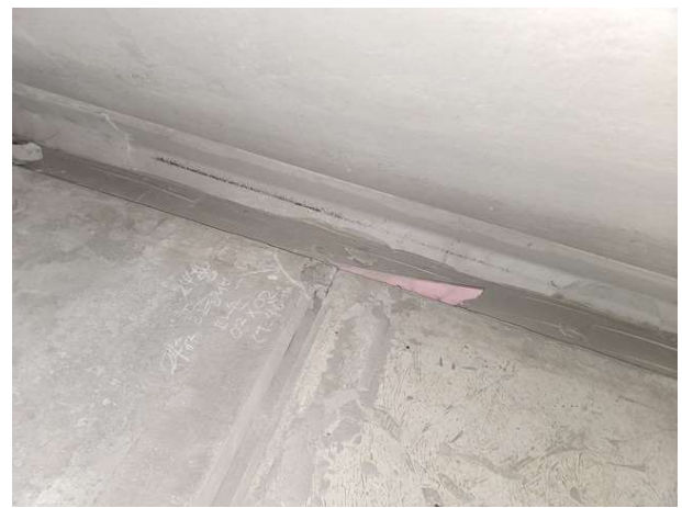
풍도슬래브 상면 S53 파손
