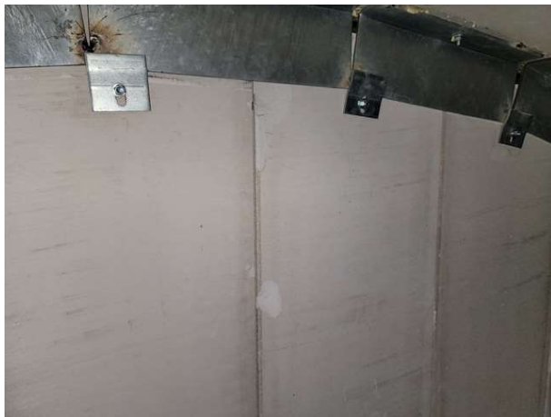
풍도슬래브 격벽 S54 파손
