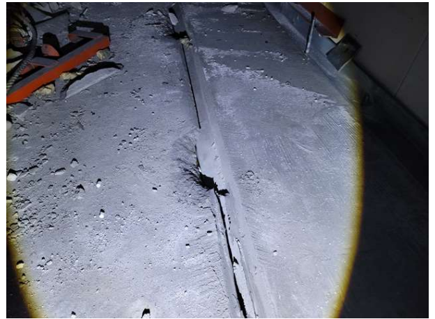
풍도슬래브 상면 S54 파손
