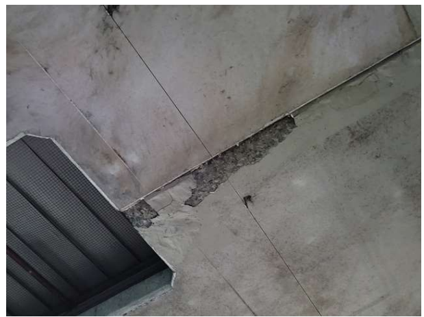
풍도슬래브 하면 S53 파손
