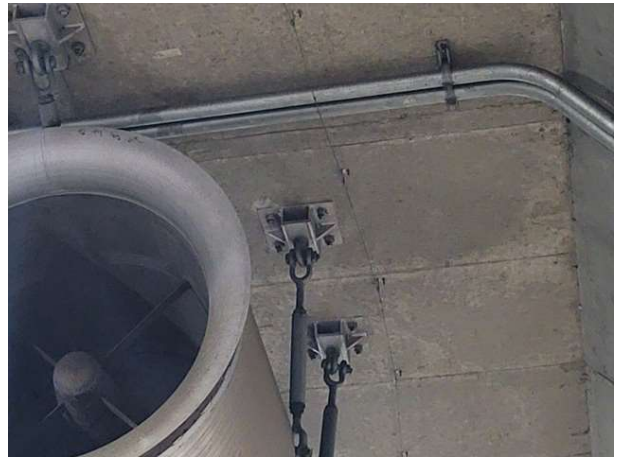
부대시설 S56 제트펜 볼트 상태양호
