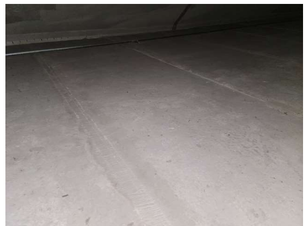
풍도슬래브 상면 S52 이음부 몰탈 파손
