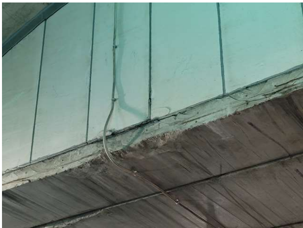
풍도슬래브 하면 S54 파손
