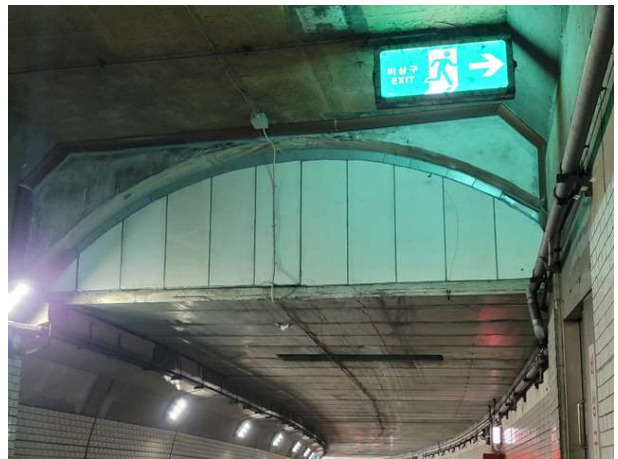
풍도슬래브 격벽 S54 파손
