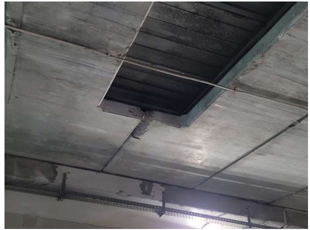
풍도슬래브 하면 S53 파손
