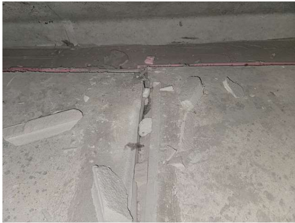
풍도슬래브 상면 S54 파손
