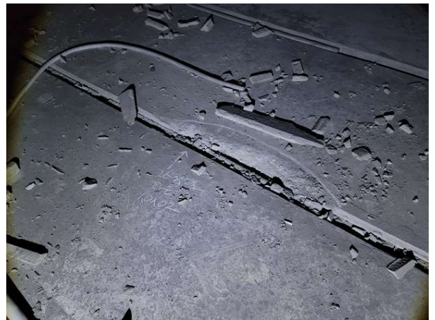
풍도슬래브 상면 S54 파손
