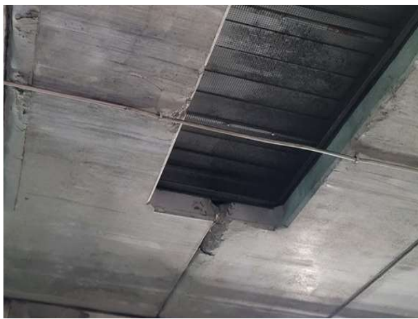
풍도슬래브 하면 S53 파손
