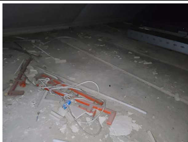
풍도슬래브 상면 S54 이음부 몰탈파손
