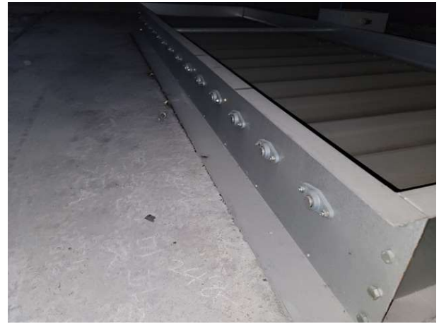
풍도슬래브 상면 S53 댐퍼 볼트탈락 및 파손
