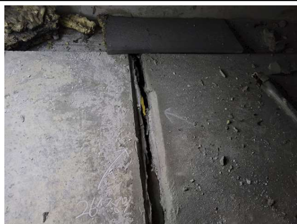
풍도슬래브 상면 S54 파손
