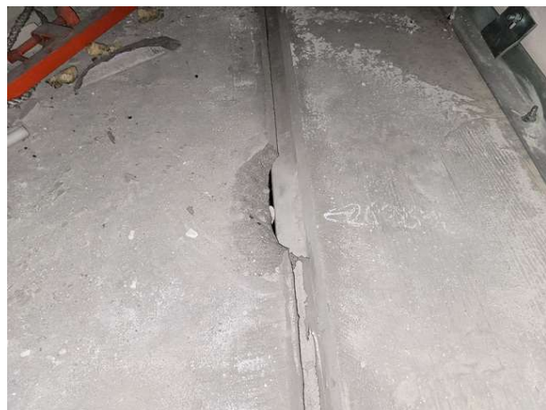
풍도슬래브 상면 S54 파손
