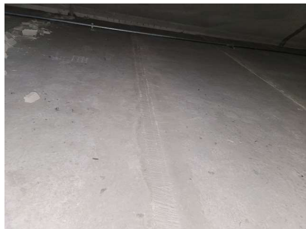
풍도슬래브 상면 S52 이음부 물탈 파손
