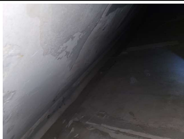
풍도슬래브 상면 S53 이음부 몰탈파손
