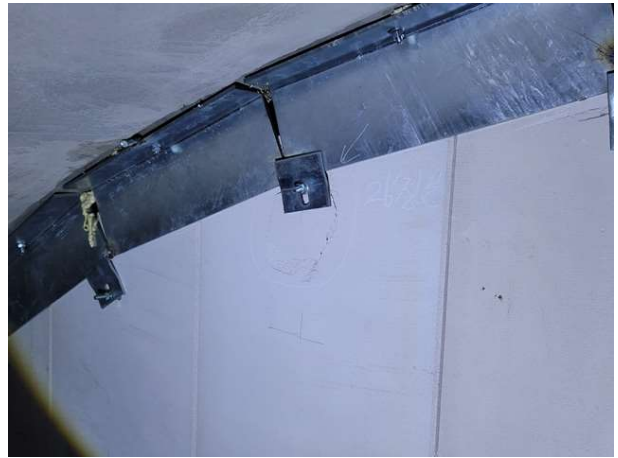
풍도슬래브 격벽 S54 파손
