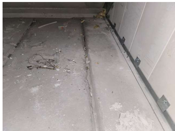
풍도슬래브 상면 S54 파손
