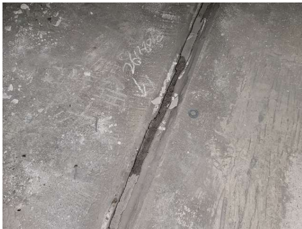
풍도슬래브 상면 S54 파손
