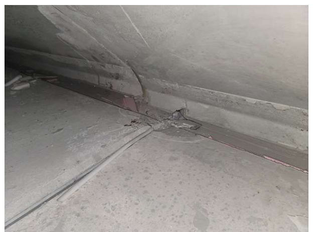
풍도슬래브 상면 S54 파손
