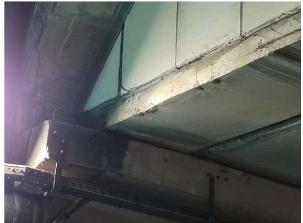
풍도슬래브 하면 S54 파손
